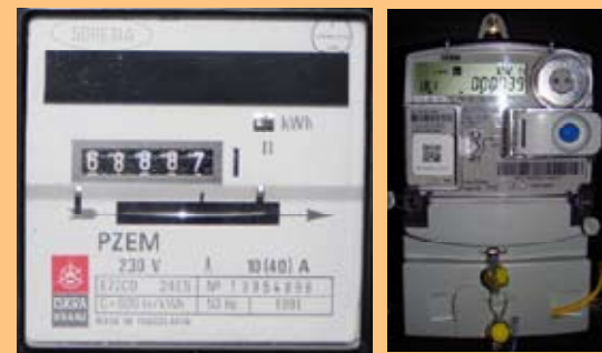
De oude terugdraaiende meter en de nieuwe slimme meter
